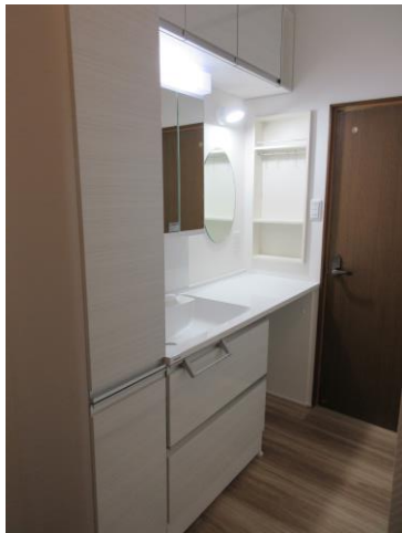
After 押し入れを撤去してお化粧もできる収納付きの大きな洗面台を設置
